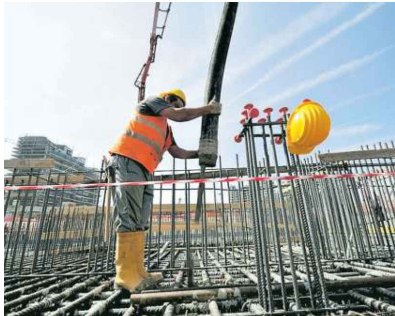
▲ Tragedia Un cantiere edile, ancora un luogo di lutti
